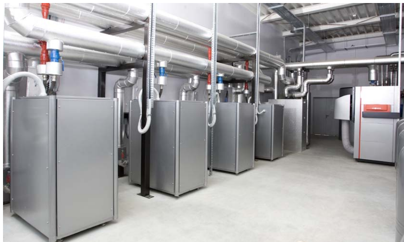
Zakład produkcyjny Dramers S.A. w Rabowicach. Układ pracy w kaskadzie Vitocal 300 i Vitocrossal 200
